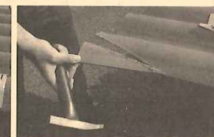
Distacco dell'angolo della lastra
