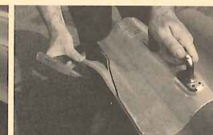
Distacco dell'angolo della lastra
